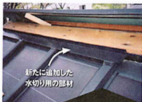
接下地 屋根パネルの端部と接下地の間に、本来必要な水切りが入っていない
